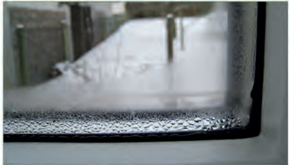
Abb. 3: Durch den Aluminium-Abstandhalter im Isolierglas kann am Rand der Glasscheibe leicht Tauwasser entstehen.
